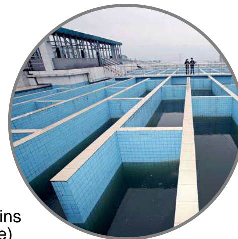
Station de traitement d'eau en France
