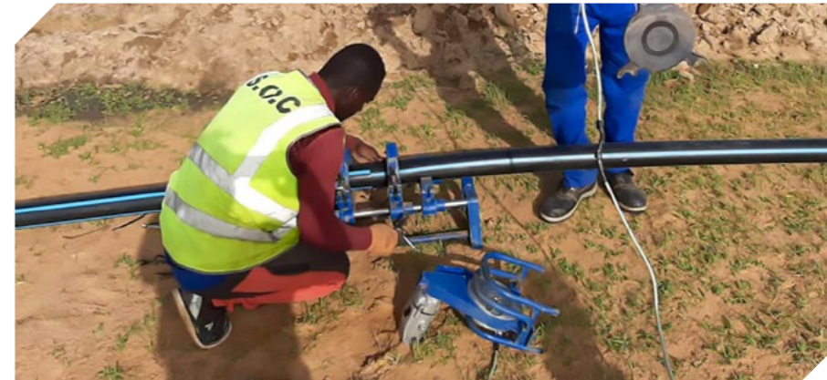
La formation des services techniques est essentielle pour la pérennité des ouvrages
