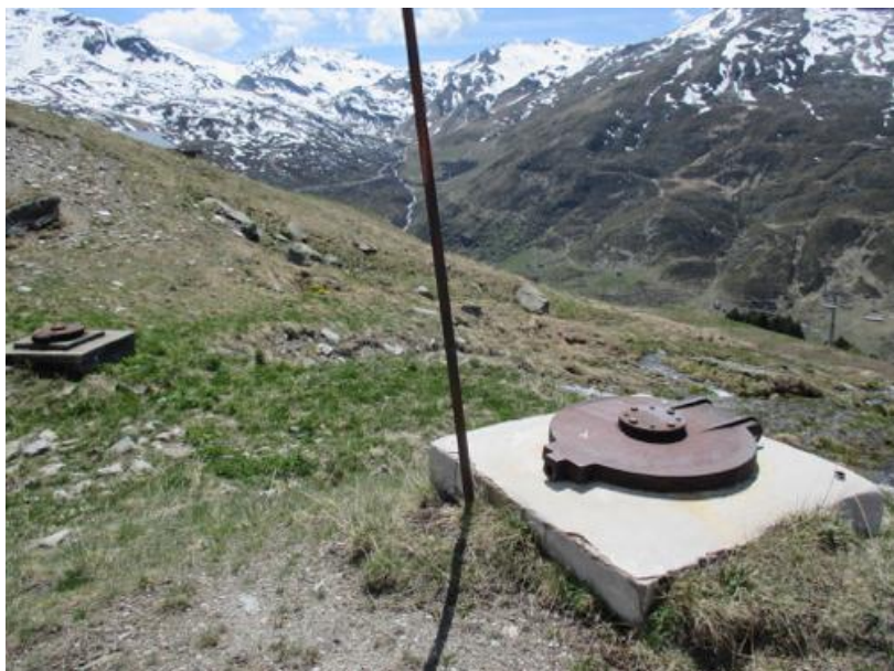
Captage de l'Ételé – les Menuires
