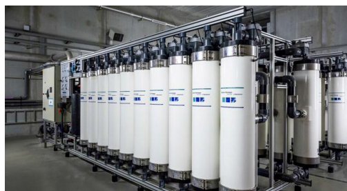
Dispositif d'ultrafiltration, usine de production d'eau des Bruyères, Les Menuires
