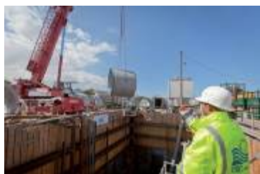
Systeme Anti-Pollution du littoral Est, nouvel ouvrage d'envergure pour une dépollution à 100%
