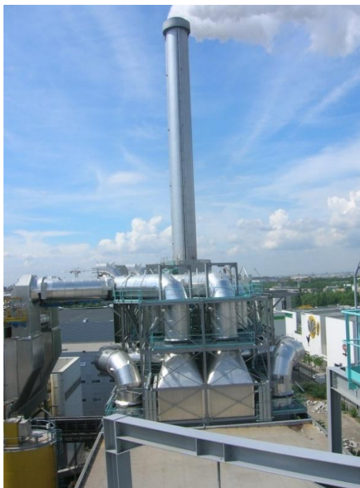
Figure 1 - vue d'une ligne de traitement des fumées
