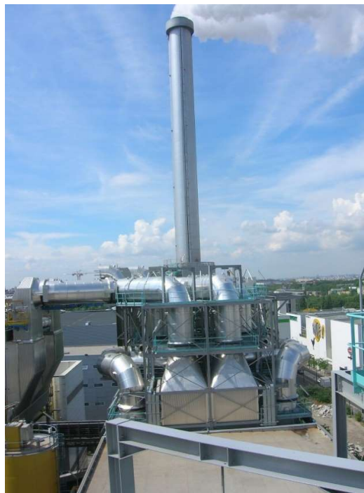
Figure 1 - vue d'une ligne de traitement des fumées
