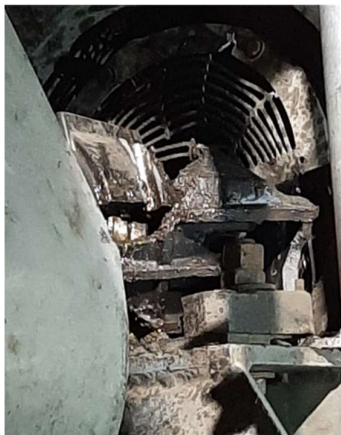
1: Cages paliers avant et arrière détruites
