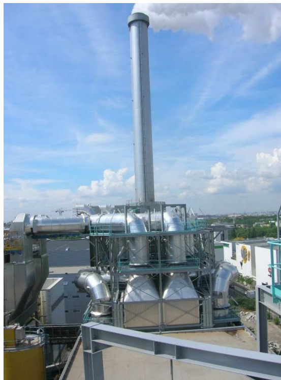
Figure 1 - vue d'une ligne de traitement des fumées
