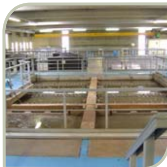
Station d'épuration (Biarritz, France)
